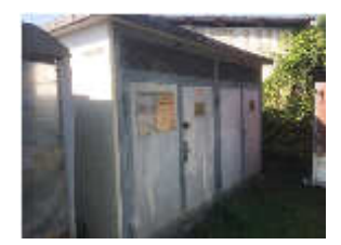
Durch Ansiedlung eines stromintensiven Gewerbes im Ratihard muss die Zuleitung und Trafostation saniert werden.
